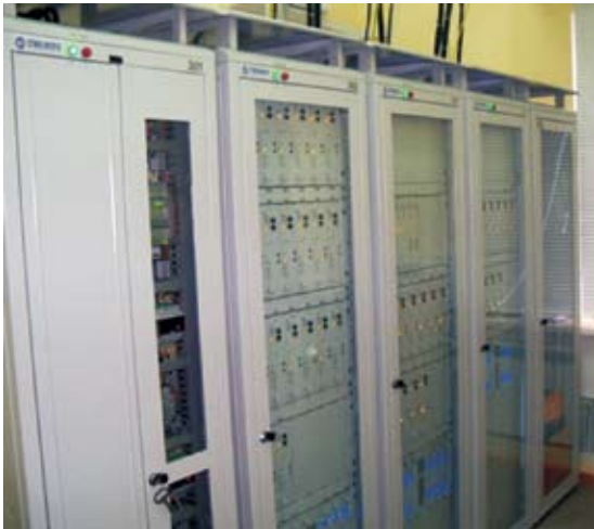
Оборудование ЦМ КРЦ АПК-ДК на посту ЭЦ станции Кусково Московской дороги
